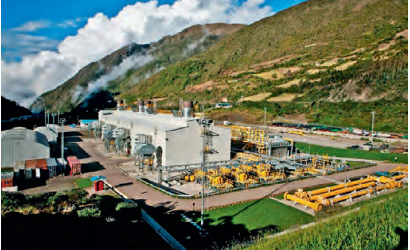
© Transportadora de Gas del Perú S.A.
