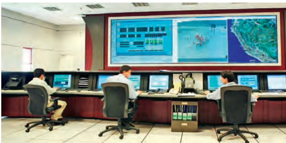
© Transportadora de Gas del Perú S.A.
